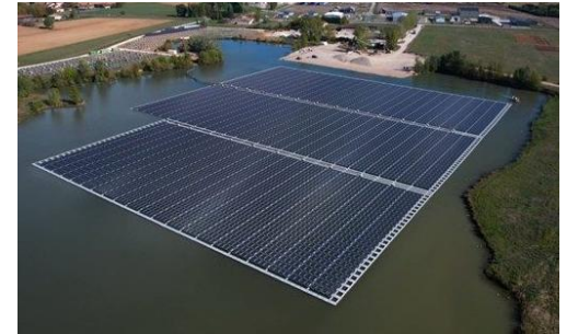
France, Montpezat, 5 MWp, 2022 Amarenco, Ciel&Terre
