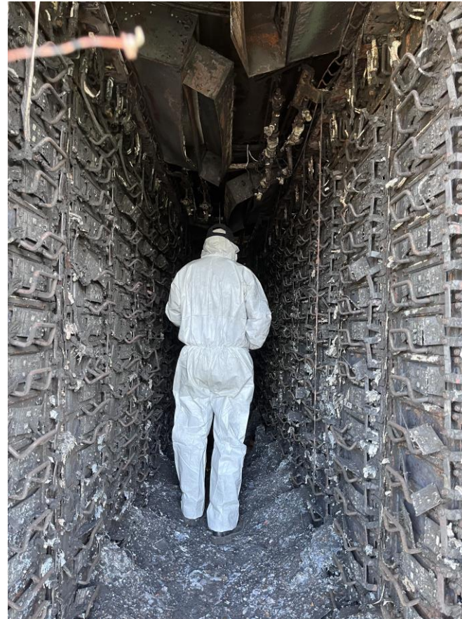
Juin 2022, feu de BESS à Poggio-di-Nazza (France)
