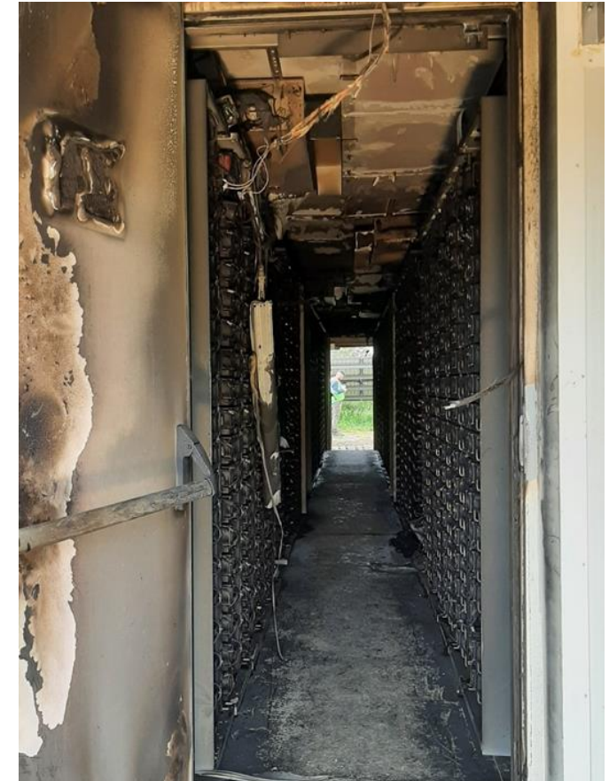
Mars 2023, feu de BESS à Aghione (France)
